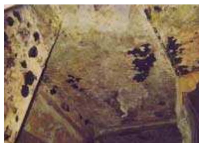
Bild 1.2.: Wasserleitungsschaden wurde nicht getrocknet
