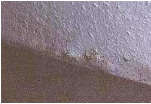
Bild 6.4.2.: Zersetzung der Raufasertapete über den Fußboden an der Außenwand
