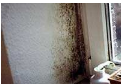
Bild 1.1.: Wärmebrücke, ungenügende Beheizung und hohe Luftfeuchtigkeit in der Wohnung über 70 % relative Luftfeuchte
