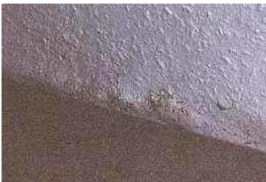
Bild 6.4.2.: Zersetzung der Raufasertapete über den Fußboden an der Außenwand
